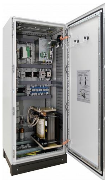
Рисунок 7б – Шкаф ШЭ 1150, вид с открытой дверью
