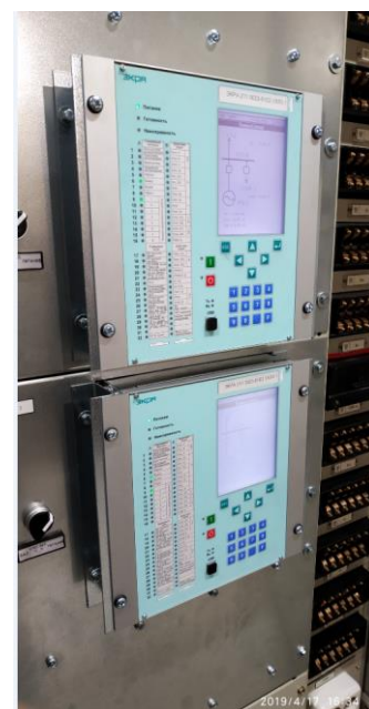
Рисунок 8 – установка терминала ЭКРА 200 в существующий шкаф
