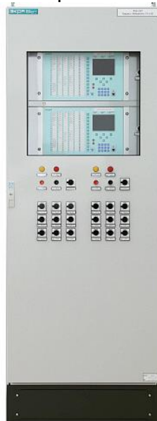
Рисунок 6а – Шкаф ШЭ 1113, вид спереди
